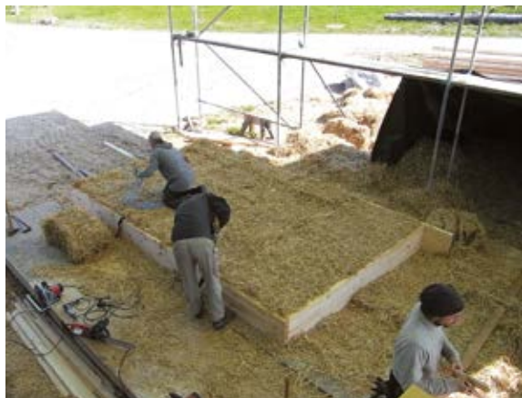
10. Nachstopfen von verbliebenen Lücken, Entfernen von Ballenschnüren (nur beim gezeigten aufrecht stehenden Einbau der Ballen möglich).
