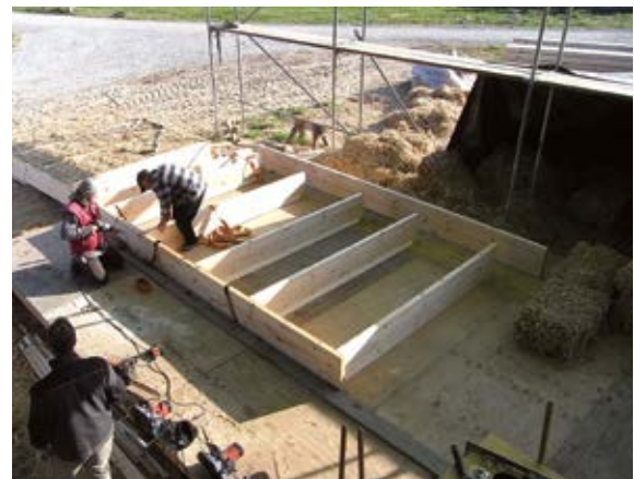
2. An den vertikalen Elementen, den Ständern, sind bereits seitlich Klemmleisten angebracht. Die Verbindung der Ständer mit Rähm und Schwelle erfolgt hier mittels Holzbauschrauben, die diagonal zur Faserrichtung der Ständer eingebracht werden.
