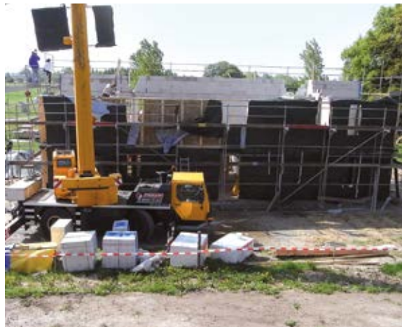
4. Aufstellen der letzten Wand im Obergeschoss. Befestigungs- und weitere Nebenarbeiten folgen, Regenschutzplanen werden angebracht.
