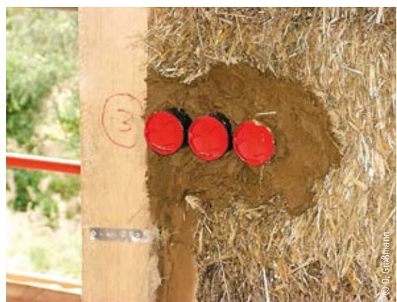
Im Lehmbett in die Strohdämmung eingelassene Elektroinstallationen
