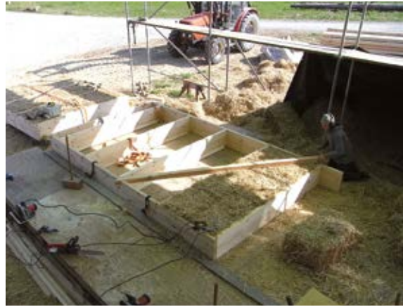
6. Vorbereitung des Einbaus einer diagonalen Strebe, die jedes Wandelement entweder nur zur konstruktiven Sicherung oder zur späteren Gebäudeaussteifung erhält.
